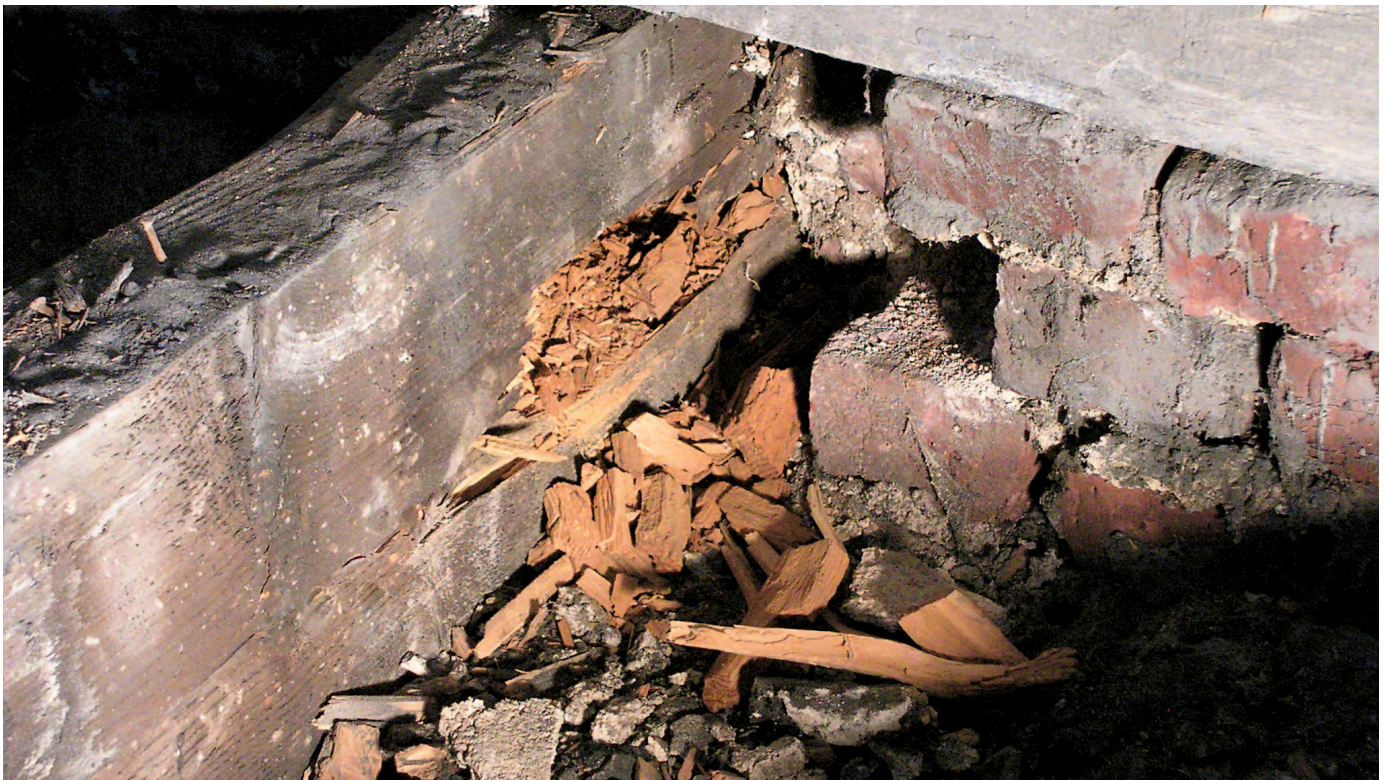
Abbildung 1: Geschädigte Balkenköpfe einer Holzbalkendecke
