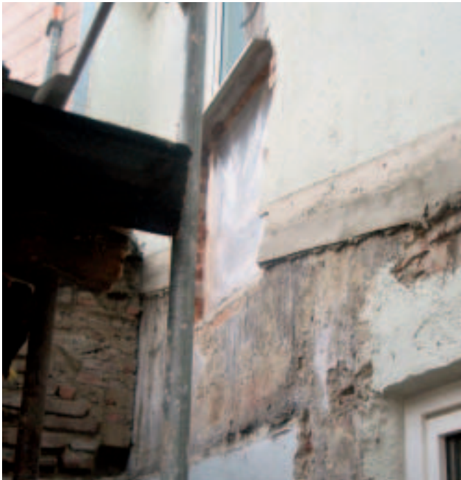
Fassade eines Altbaus im unsanierten Zustand.
