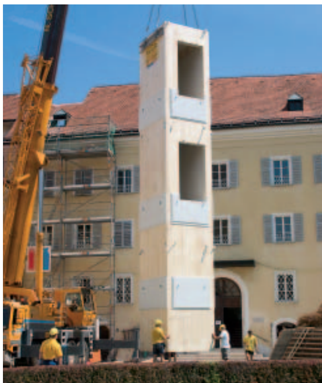
Aufzugschacht in Bad Reichenhall
