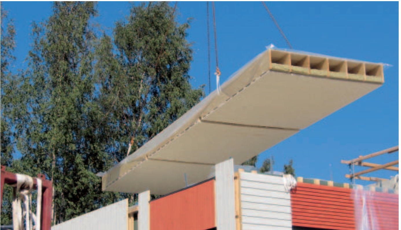
Hohlkasten mit Dämmung, unterseitig mit Gipskarton und oberseitig mit Folie (regensicher) versehen.
